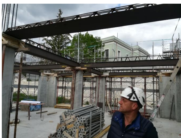
Costruzione del nuovo edificio in cemento armato con Solai in calcestruzzo alleggerito (esempio di ordine in cantiere)
